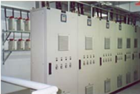
Fornecimento e integração de sistema Correção Fator de Potência
