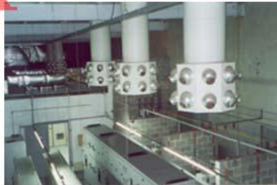
Sistema de ventilação e exaustão da casa de máquinas/subestação
