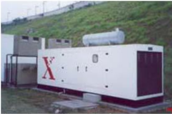
Infra-estrutura de Grupo Gerador
